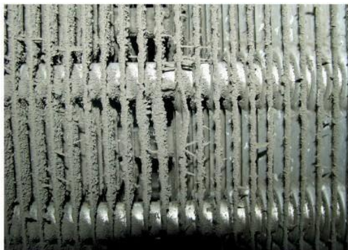
Cooler-ul, înainte de expunere la lumina ultravioletă UV-C
